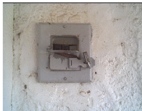
Figura 2 – Detalhe de um quadro de distribuição em uma das escolas.
